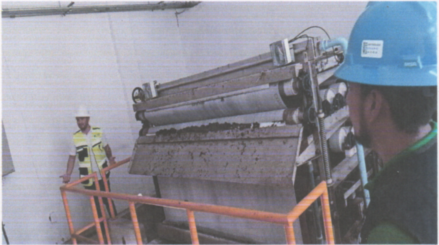
Tratamiento de lodos
