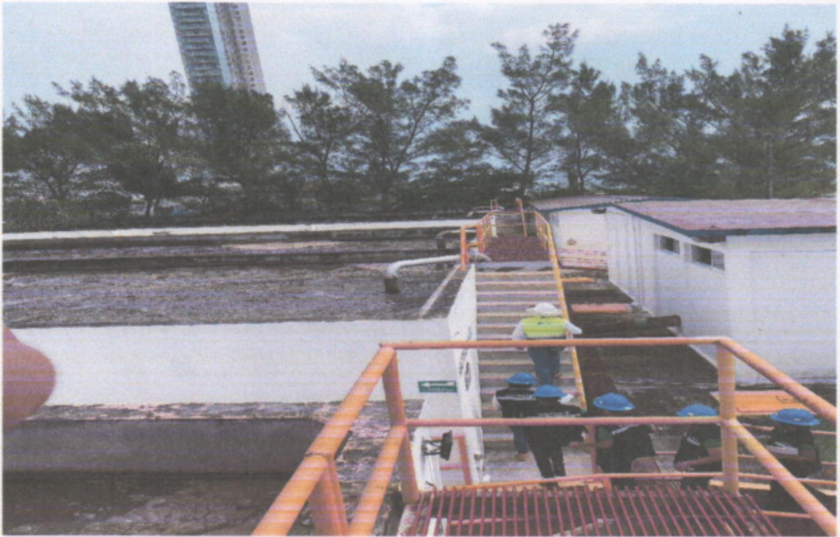
Tanques de tratamiento aerobio
